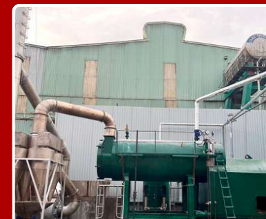
LÒ HƠI CÔNG NGHIỆP
