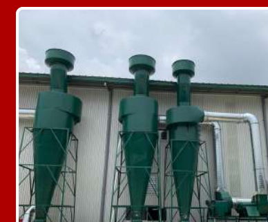
HỆ THỐNG XỬ LÝ BỤI
