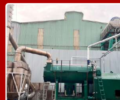
LÒ HƠI CÔNG NGHIỆP
