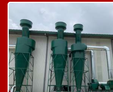
HỆ THỐNG XỬ LÝ BỤI
