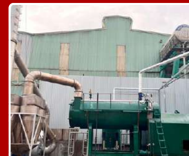
LÒ HƠI CÔNG NGHIỆP
